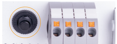
Heizkreissicherung durch Drücken zurücksetzen
